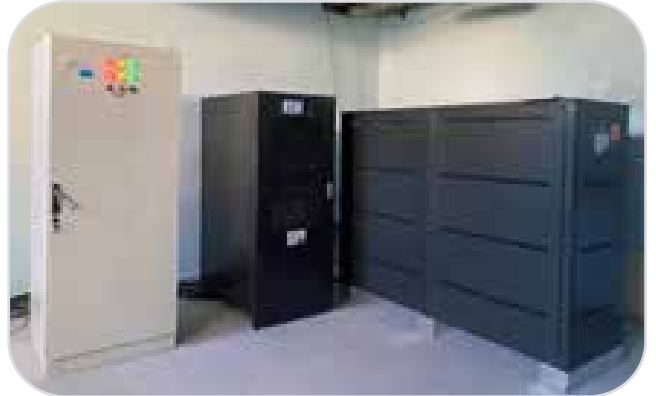
Jeneratörler ve UPS
