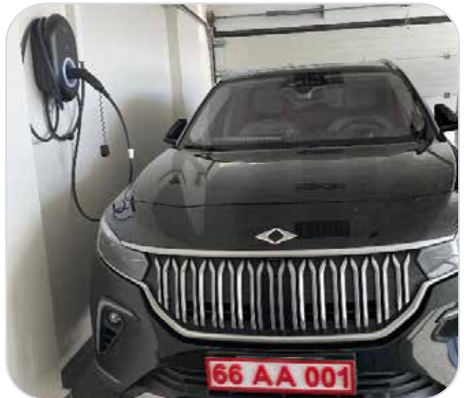
Elektrikli Araç ve Şarj İstasyonu
