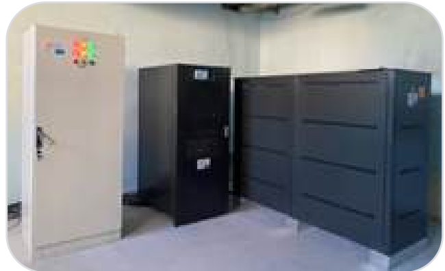
Jeneratörler ve UPS
